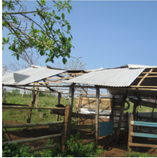
Imagen 32. Desprendimiento de láminas por vientos torrenciales dentro de instalaciones pecuarias
